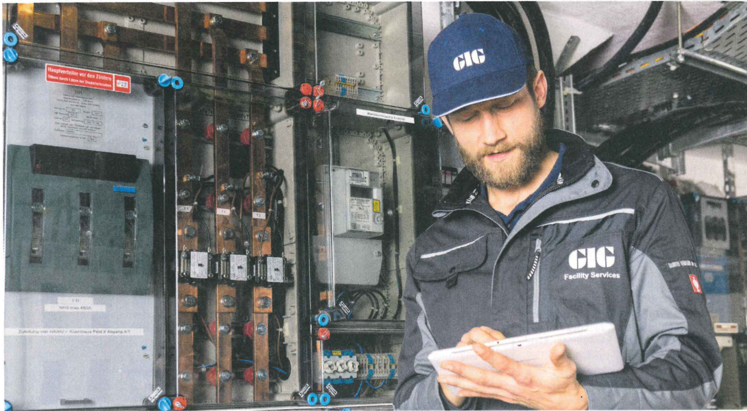
Aufträge werden vom Techniker auf dem mobilen Endgerät dokumentiert.
